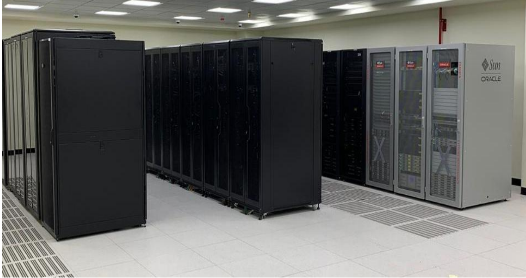
مركز البيانات بعمادة تقنية المعلومات
