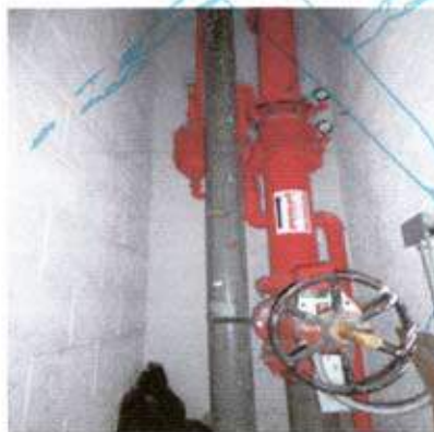
Alarm System أجهزة التنبيه للحريق هيدروليكية
