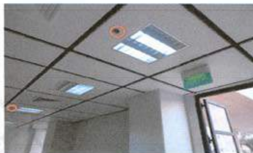
مرشات إطفاء الحريق الآتوماتيكية Automatic Fire Sprinkler System
