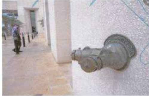
( وصلات الدفاع المدني Firemans Connection )
